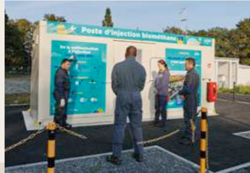
Poste d'injection biométhane
